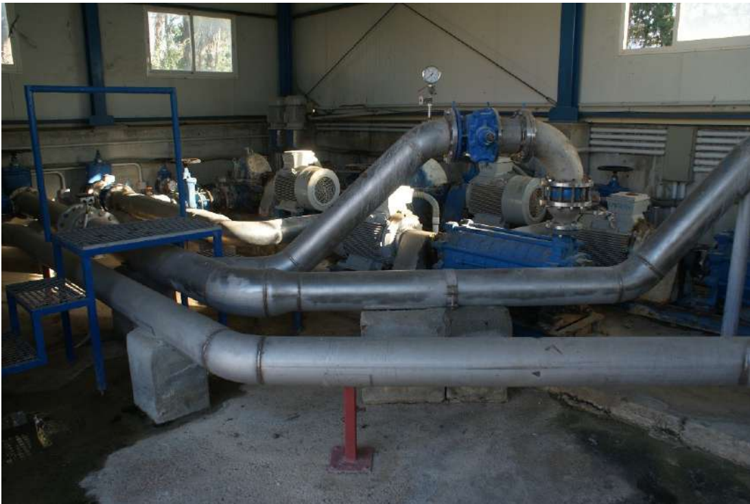
Figura 28. Fotografía del sistema de bombeo. (Fuente: autor)
